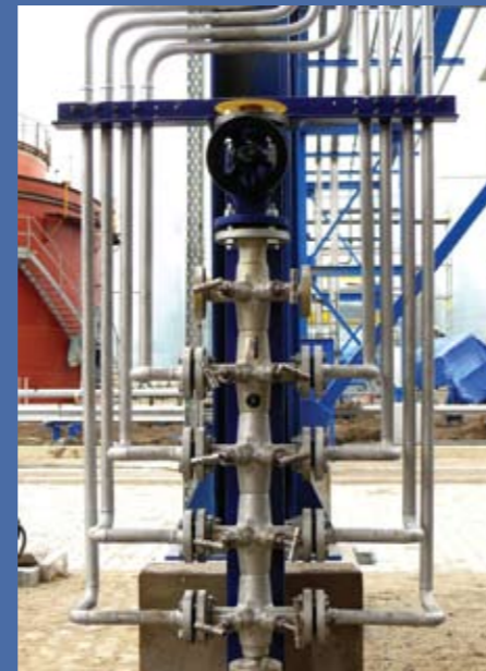
Stacja rozdziału pary bez izolacji
