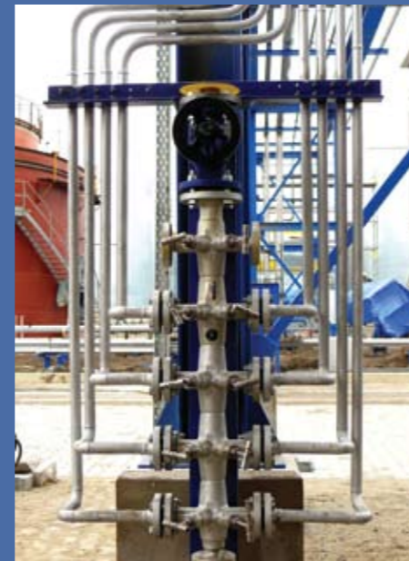
Stacja rozdziału pary bez izolacji
