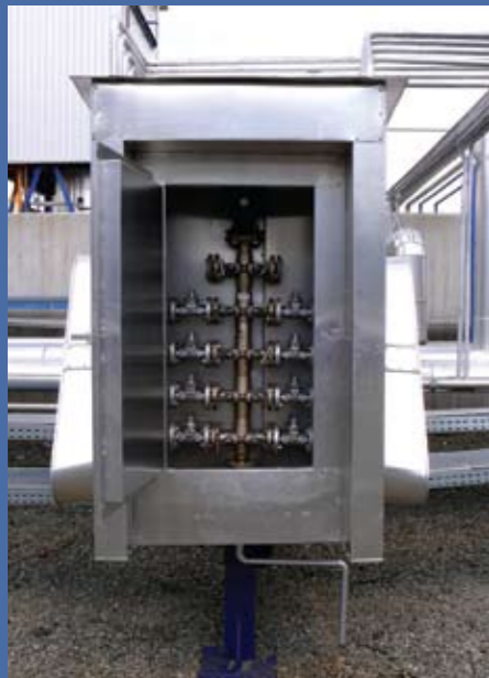
Stacja zbioru kondensatu z odwadniaczami termostatycznymi w skrzyni izolacyjnej
