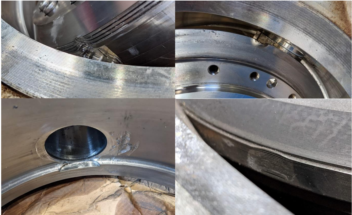
Uszkodzenia elementów przepustnicy elementem metalowym
