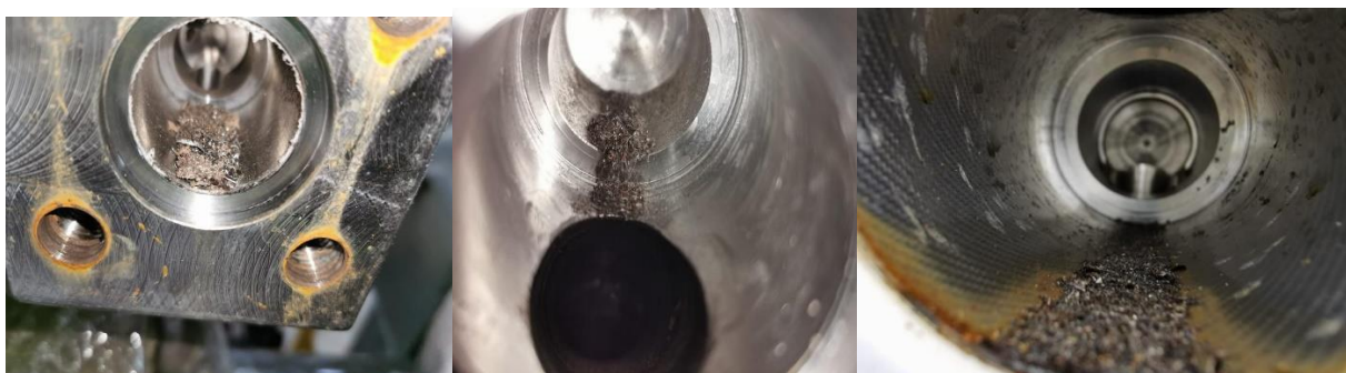
Pozostałości po czyszczeniu instalacji tlenowej w korpusie zaworu.
