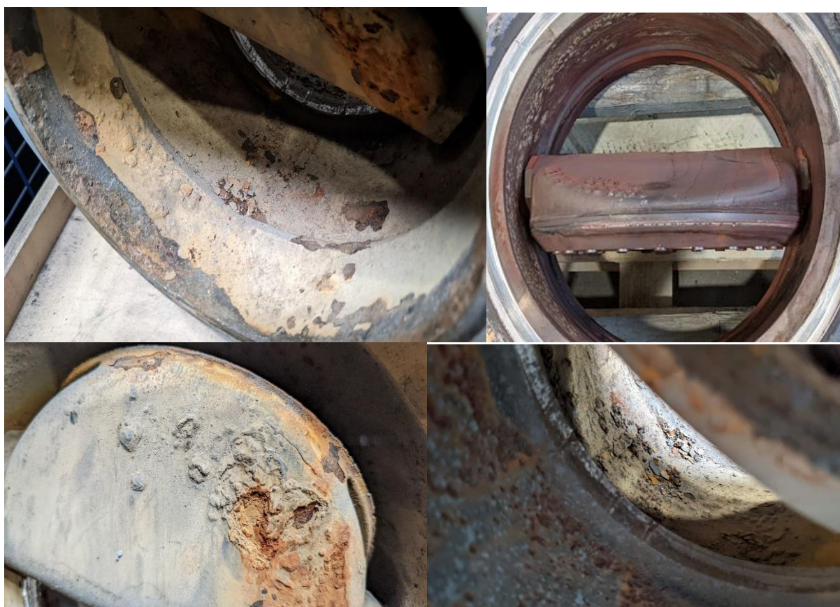
Uszkodzenia przepustnicy pracującej na rurociągu pary spowodowane kamieniem kotłowym.
