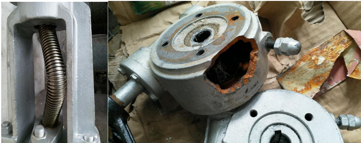
Uszkodzenie trzpienia zasuwki klinowej i przekładni spowodowane elementem stalowym który utkwiał pomiędzy klinem zasuwki i korpusem. Obsługa próbowała zamknąć za wszelką cenę zasuwę przy użyciu 2 metrowego klucza typu „F”
